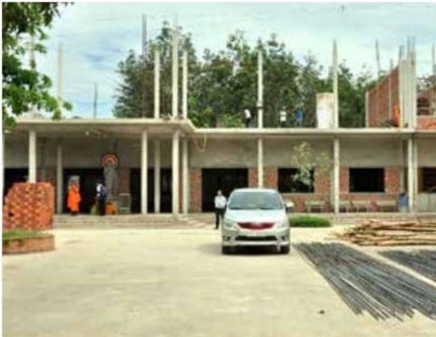
Tầng xá đang trong quá trình xây dựng Ảnh: Danh Trường - năm 2020
