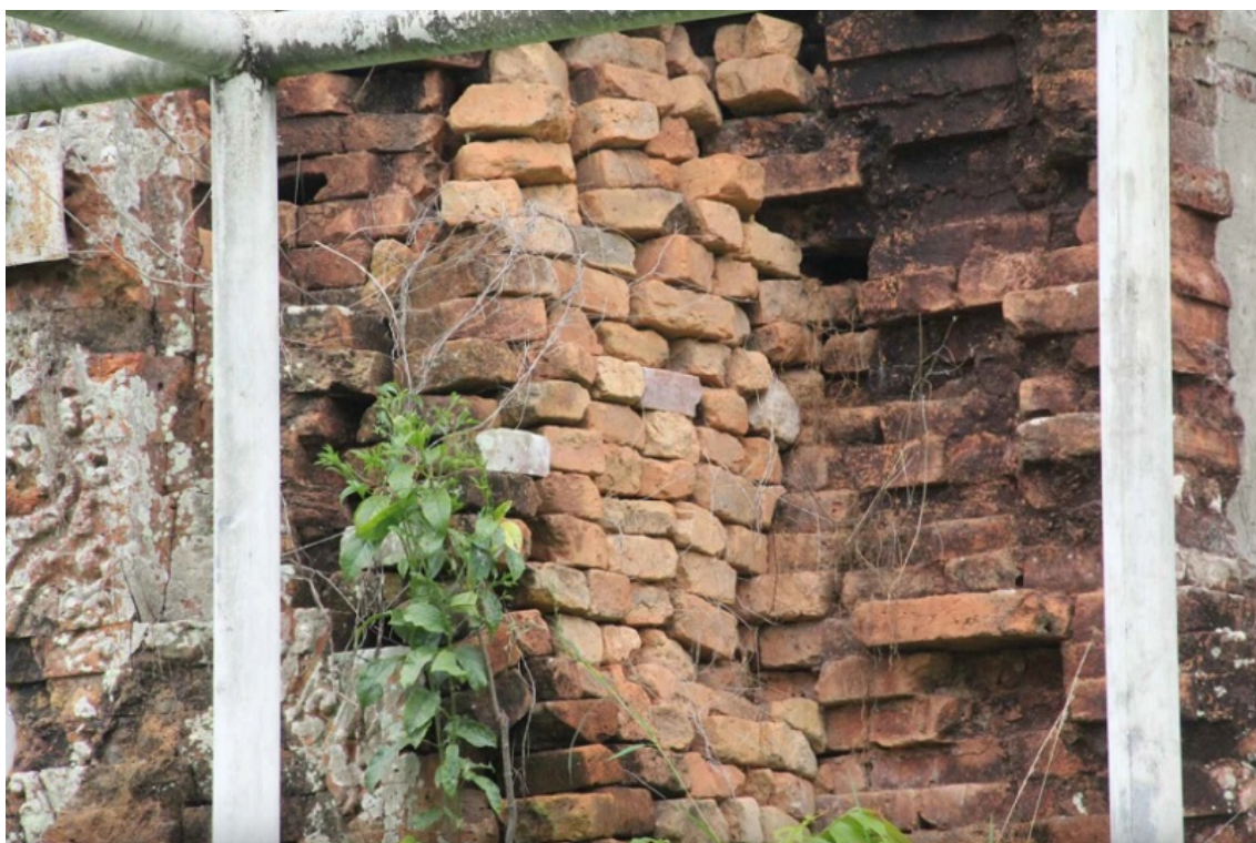
Gạch vữa tháp Sáng bị rơi rớt do xuống cấp. ẢNH: MẠNH CƯỜNG
